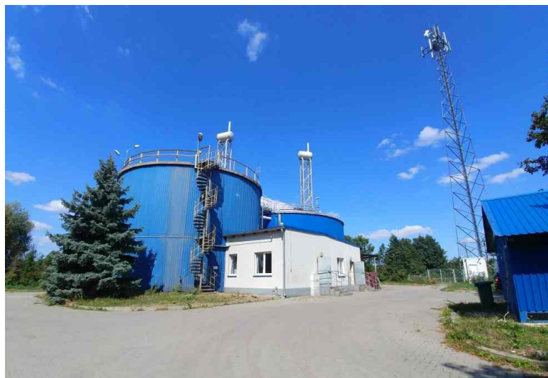
Fot. 20. Oczyszczalnia ścieków w Moszczenicy. Fot. I. Pecyna.
