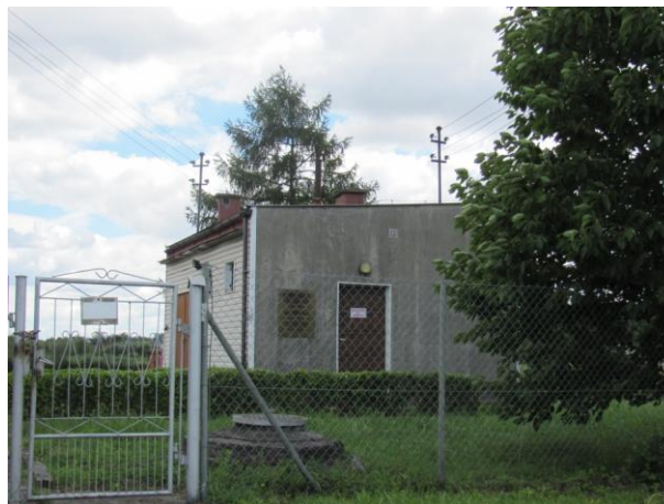
Fot. 41. Oczyszczalnia ścieków w Krasnem
